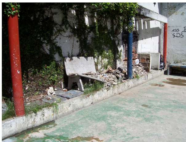
Figura 5 – Banco quebrado no pátio do Recicriar.
