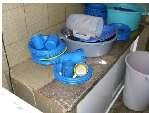
Escola Pio XII – Superfícies das bancadas em mau estado de conservação.
