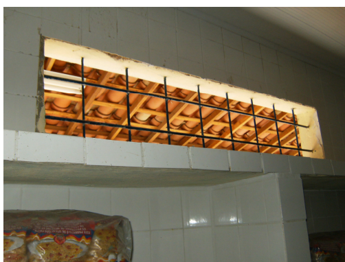
Escola Aureliano Gonçalves – Ausência de telas de proteção no depósito de merenda.
