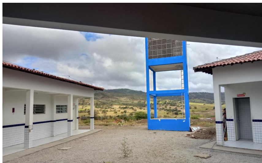
Figura 3: Ausência de muro na Escola Manoel Francisco de Lira
