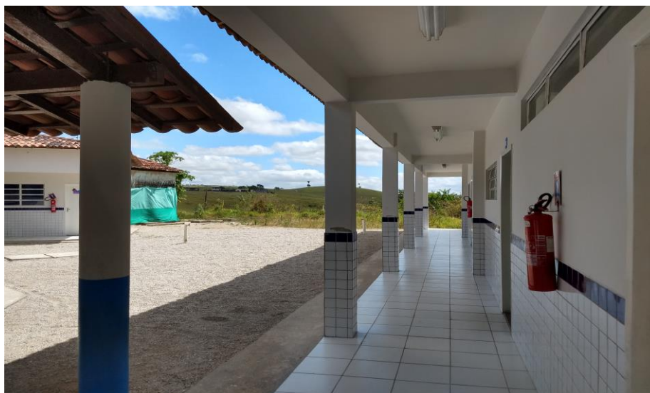
Figura 2: Ausência de muro na Escola Osvaldo Cruz
