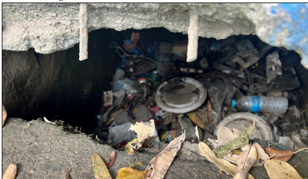
Figura 09- Boca de lobo obstruída com resíduos sólidos.
