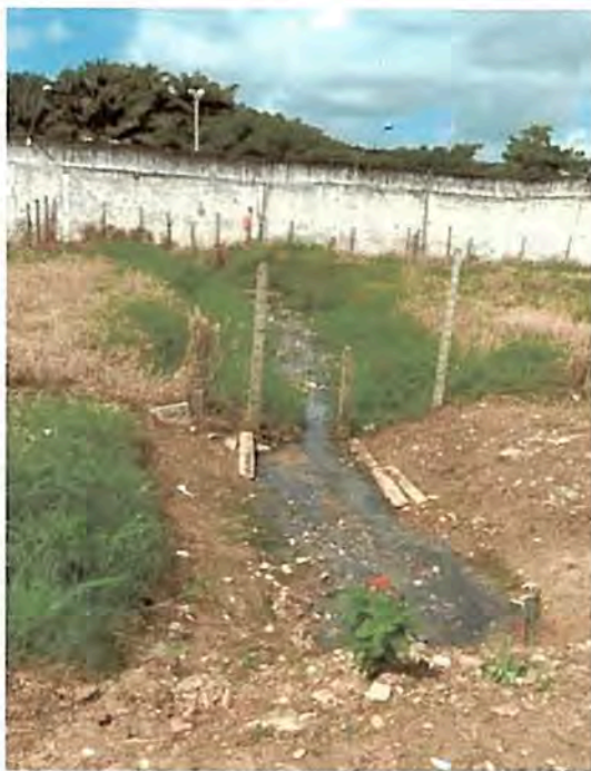
Esgoto a céu aberto
