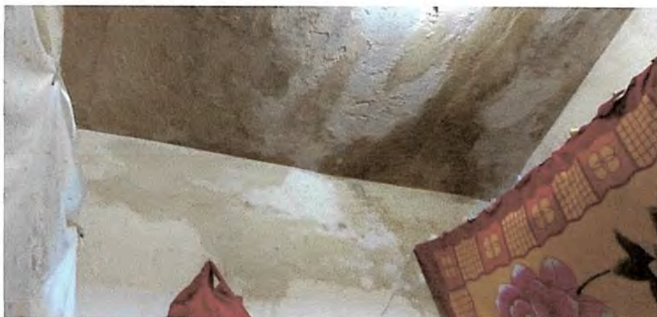
Infiltração teto de cela
