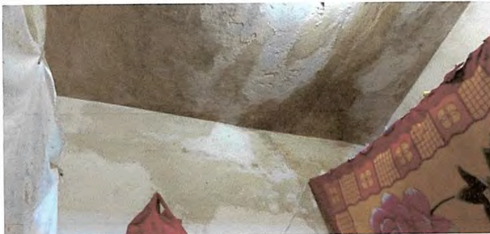
Infiltração teto de cela
