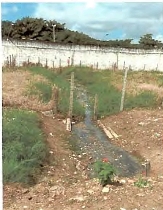
Esgoto a céu aberto
